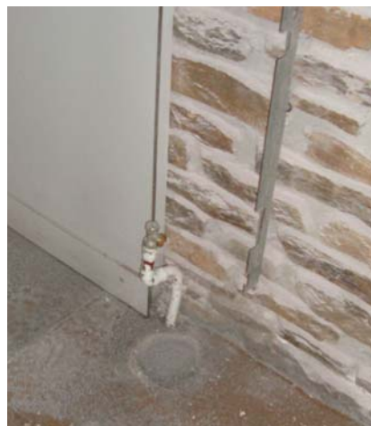
Foto: Circuito enterrado de Calefacción Ed. Telecabina-Borreguiles.
