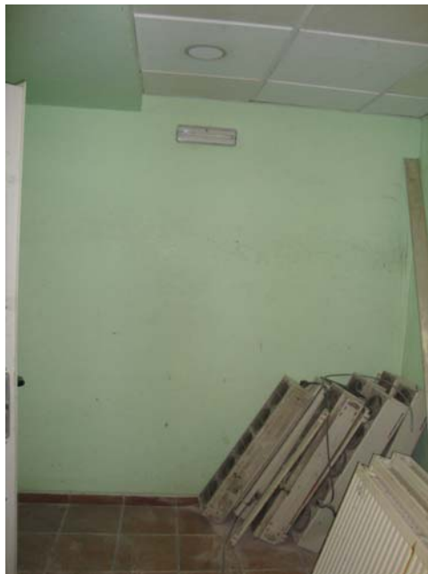
Foto: Ubicación de la nueva montante del circuito 1.
