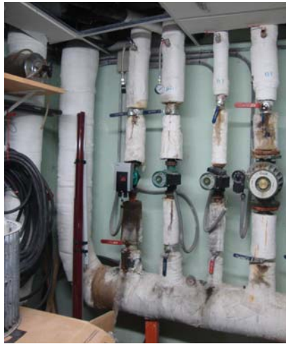
Foto: Colector Calefacción Ed. Telecabina-Borreguiles.
